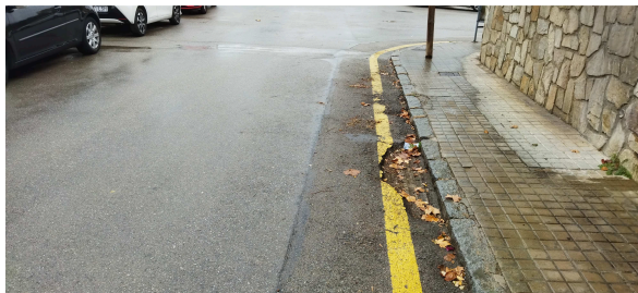
Vista del desperfecte
