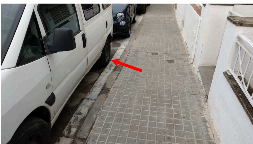
Vista des del costat del defecte
